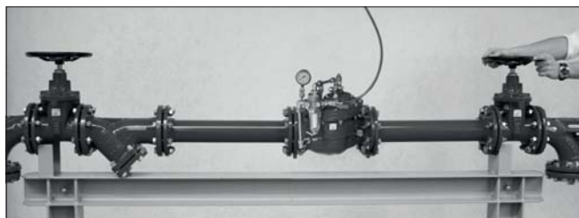
Obr. 28: Plné otevření uzavíracích armatur
