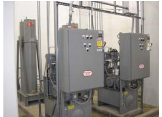
Zwei Hochdruck-Hydraulikaggregate mit Druckspeicher.
