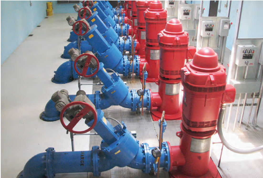
VAG CHECKtronic Pumpenschutzarmaturen verbessern durch ihre strömungsgünstigen Eigenschaften und ihre Ausfallsicherheit die Wasserpumpstation in der Clinton Avenue
