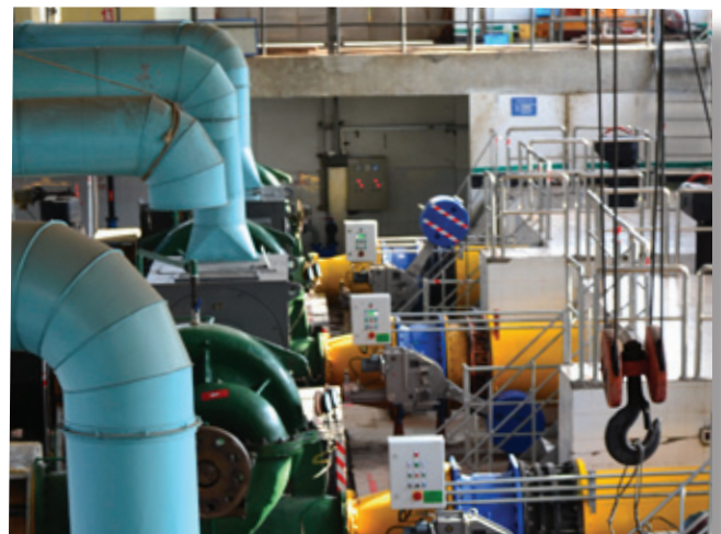
Estación de bombeo
