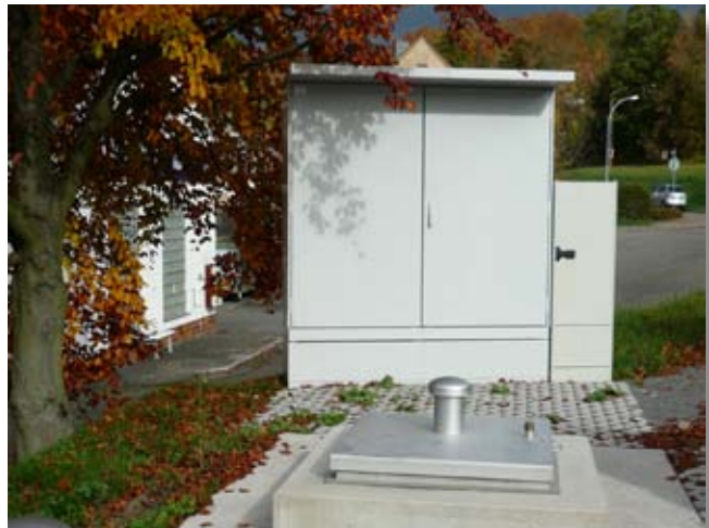
Vue extérieure de l'armoire de distribution
