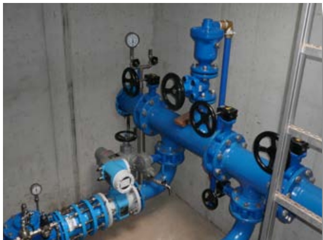
Salida a la zona de presión media con válvula de mariposa VAG CEREX® 300-L con engranaje y volante, además de accionamiento eléctrico
