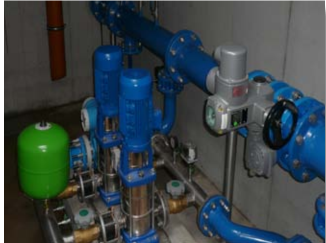
La estación de bombeo / estación elevadora de presión
