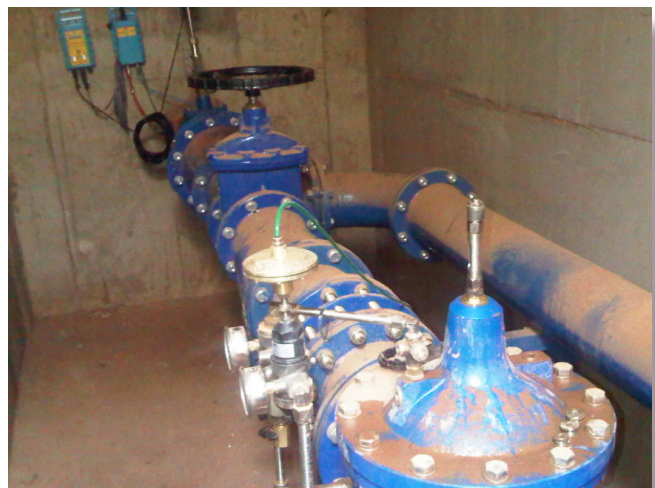
Chambre de montage des vannes
