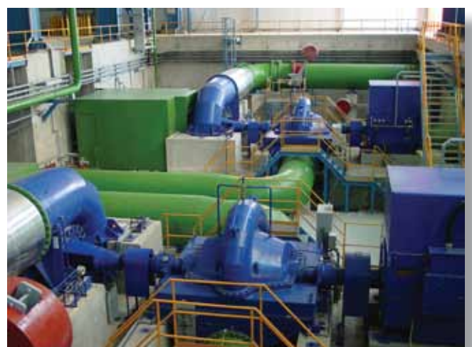
Sala de máquinas; área hidráulica
