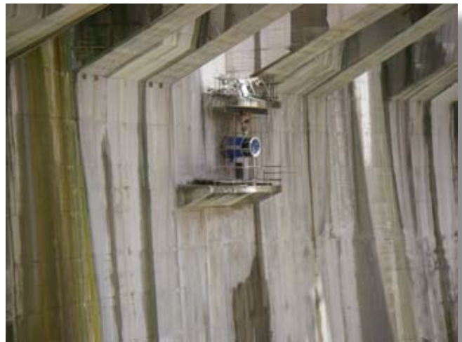
Eingebauter VAG KSS Kegelstrahlschieber
