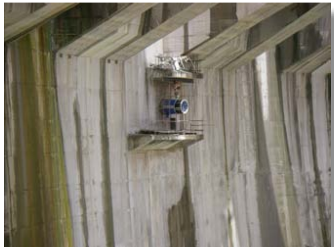
Válvula de descarga de fondo VAG KSS instalada
