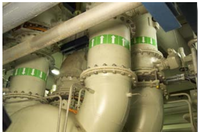
Válvulas de mariposa VAG EKN® de DN 800 y PN 10 en el área del condensador
