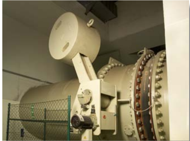
Válvula de mariposa VAG EKN® de DN 2000 y PN 6 como válvula de protección de bomba con accionamiento de contrapeso hidráulico en el edificio de bombas detrás de la bomba principal de agua refrigerante
