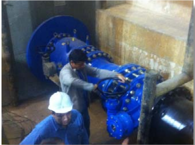
Eingebautes VAG RIKO® Ringkolbenventil DN 500, daneben eine VAG EKN® Absperrklappe während der Inspektion
