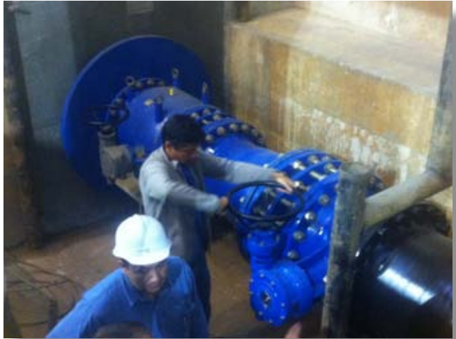
VAG RIKO® Vanne annulaire montée DN 500, à côté une VAG EKN® Vanne-papillon pendant l'inspection
