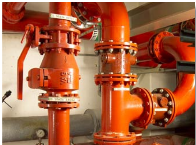
Válvula de retención VAG RETO-STOP, válvula de compuerta VAG BETA® 200 y válvula de retención de asiento inclinado VAG SKR en la estación elevadora de presión del sistema contraincendio
