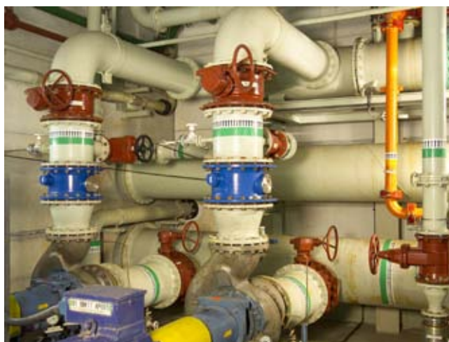
Válvulas de mariposa VAG EKN®, válvulas de compuerta VAG EKO® plus y válvulas de retención de asiento inclinado VAG SKR en la estación de bombeo del sistema contraincendio
