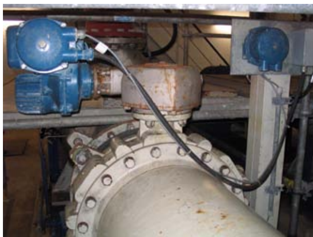
Válvulas de mariposa VAG CEREX® 300 y válvulas de retención de asiento inclinado VAG SKR en la cámara de toma
