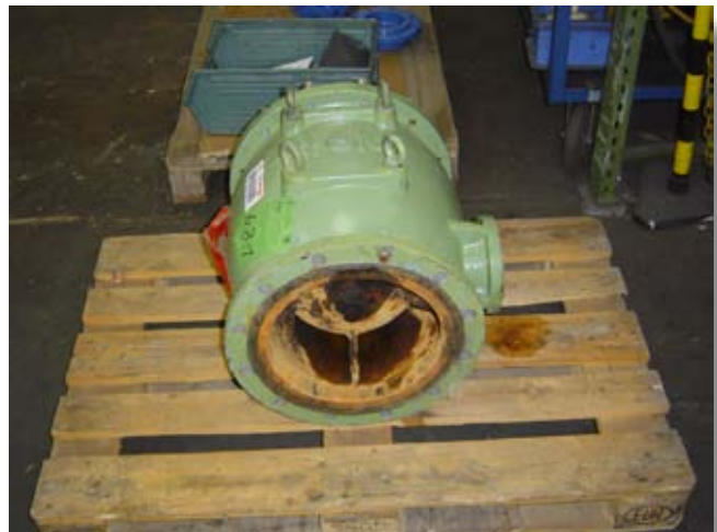
Válvula de paso anular con sedimentos del medio claramente visibles
