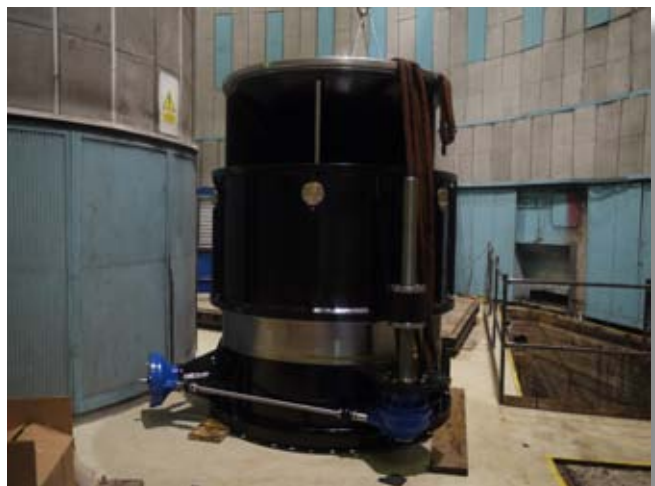
La válvula de descarga de fondo VAG KSS dentro de la torre
