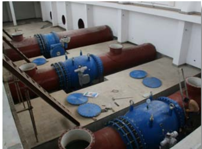
Válvulas de paso anular VAG instaladas
