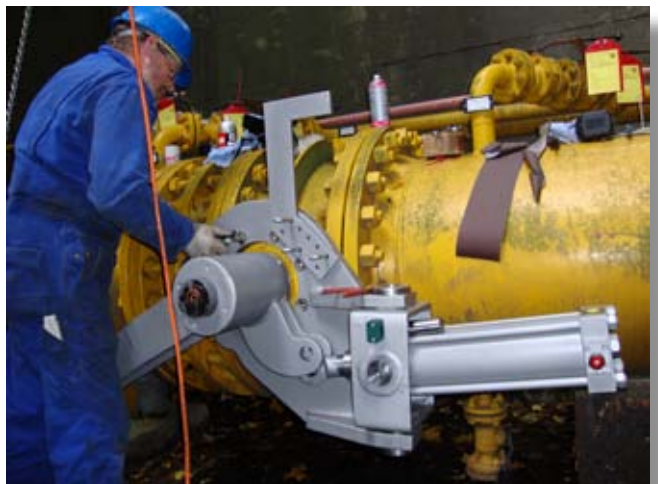
Nuevo accionamiento de contrapeso hidráulico instalado
