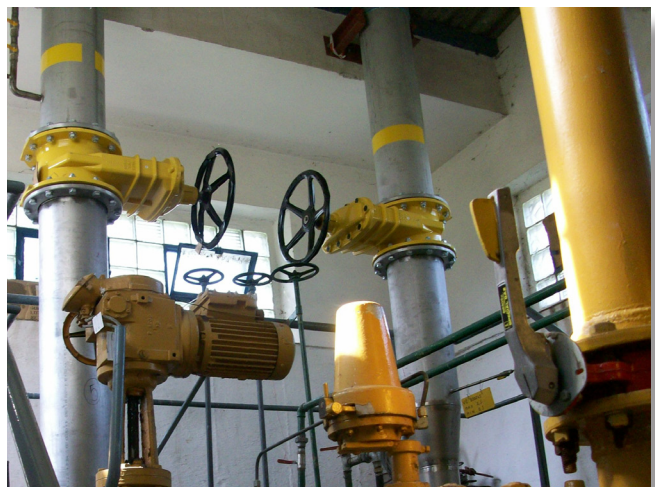
Installierte VAG BETA® 300 Absperrschieber
