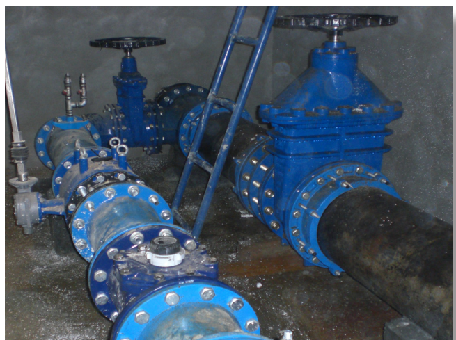
Chambre de montage des vannes
