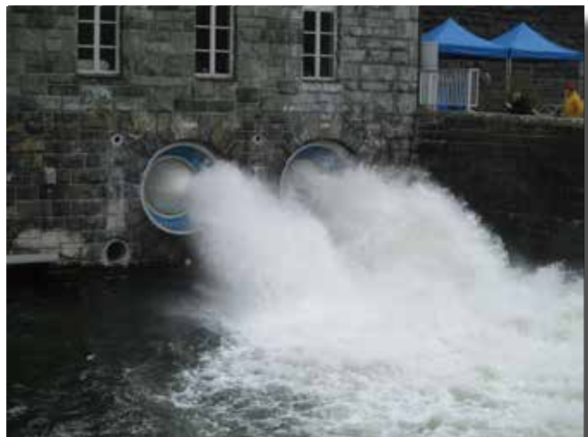
Los nuevos válvulas de descarga de fondo en uso
