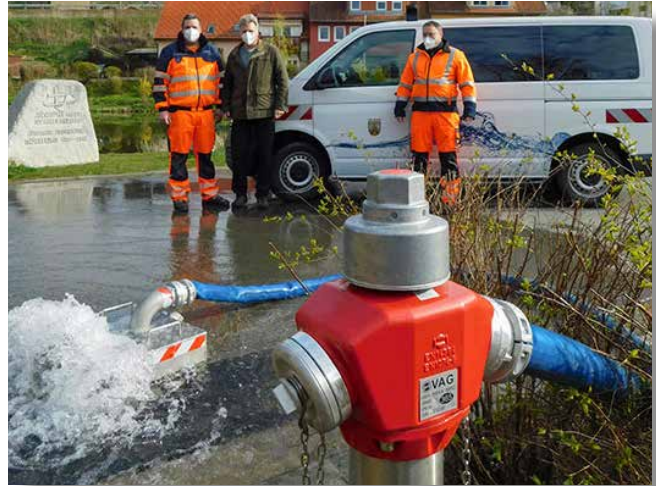
VAG NOVA NIRO 365 Überflurhydrant im Funktionstest
