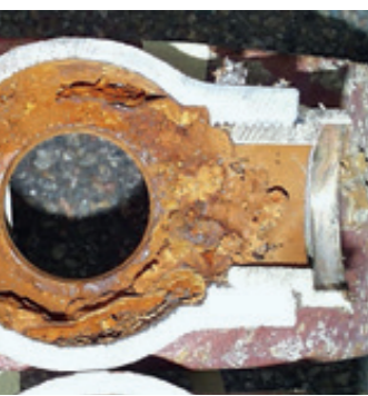
Abb. 2: Korrosion im Gewindebereich
